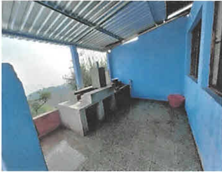
Foto 8: SUSTICION DE CUBIERTA TRADICIONAL CON MADERA POR LAMINA TROQUELADA CALIBRE 26.
